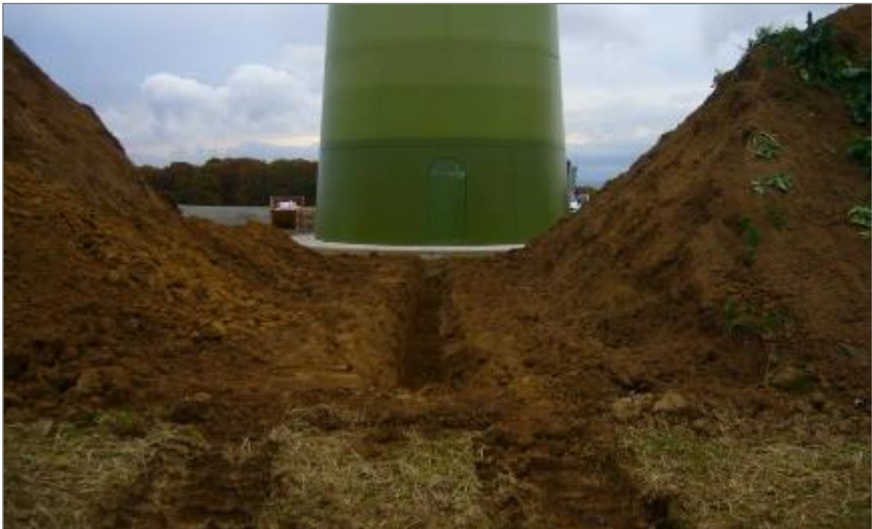
Abb. 10: Kabeltrasse einer WEA (© wind.bau GmbH & Co. KG, www.wind-bau.de )
